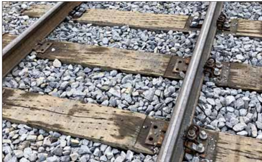
Systemschwelle im Gleisbett
